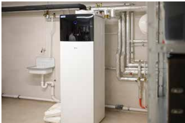
Wo einst ein Ölkessel stand, steht jetzt eine moderne Wärmepumpe.
