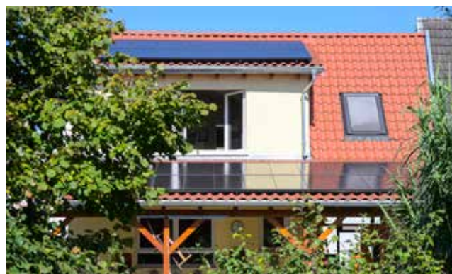
Ein 120 Jahre altes umfassend saniertes Haus in Plankstadt – erneutes Dach und Außenwände gedämmt, neue dreifachverglaste Fenster und eine Photovoltaik-Anlage mit insgesamt 9,9 kWp starken Leistung. Gülay Keskin
